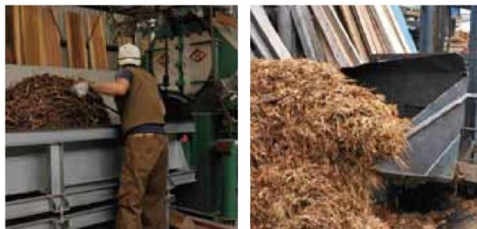
図 2-4-3 有限会社沖倉製材所の木質バイオマスボイラー 19
