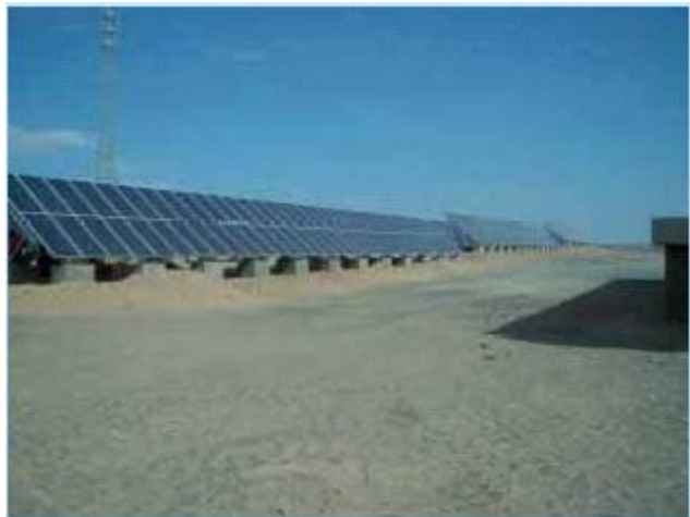
【写真1】中国・甘肅省ヤードン 太陽光発電ユニット
